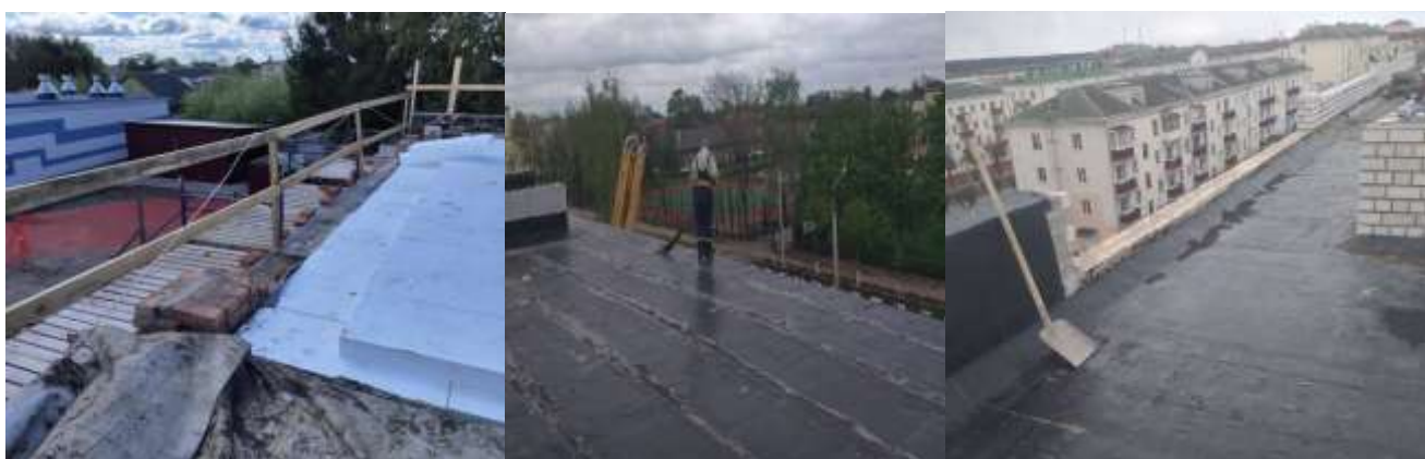
Временные перильные ограждения в зоне производства работ на крыше по периметру производства работ:
